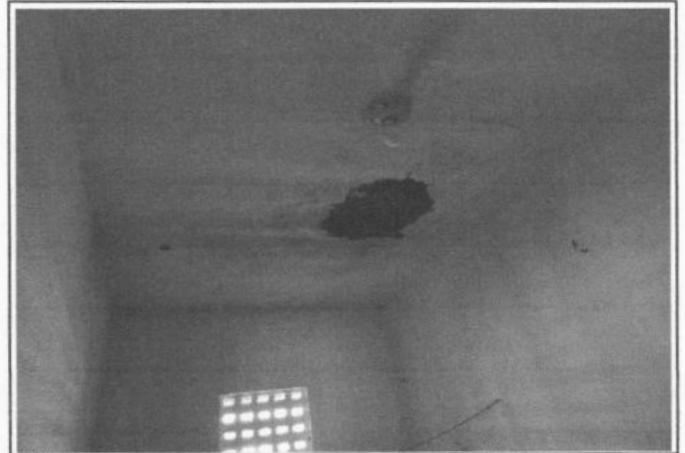
FOTO 20 - DESCOLAMENTO DE REVESTIMENTO DE FORRO
