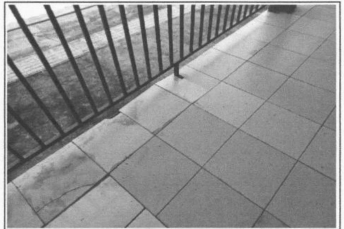
FOTO 16 - DESCOLAMENTOS DE PISOS
