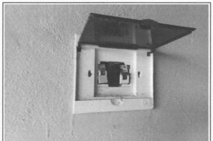
FOTO 18 - INSTALAÇÕES ELÉTRICAS NECESSITANDO REPAROS EM GERAL
