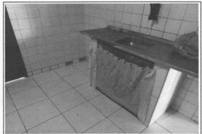
FOTO 12 - AFUNDAMENTO DO PRÉDIO
