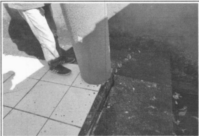
FOTO 3 - RACHADURAS DEVIDO A ABATIMENTO DO TERRENO
