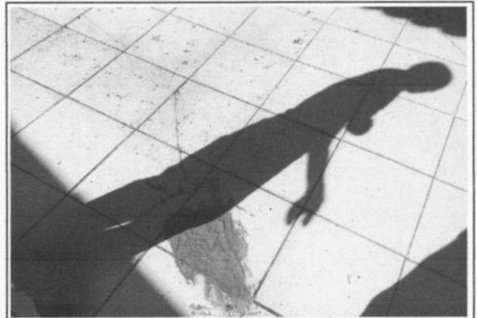
FOTO 4 - AFUNDAMENTO DE PISOS
