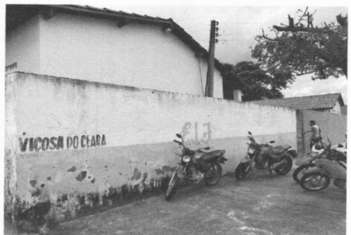
FOTO 6 - TRECHO DO MURO DE CONTORNO A RECUPERAR
