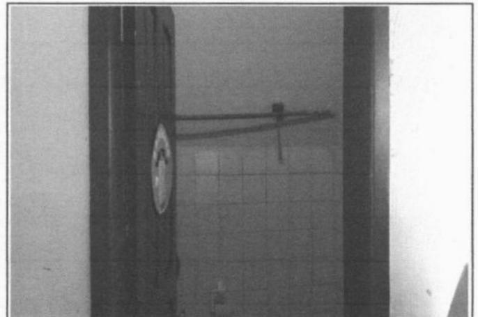
FOTO 8 - W.C. INSTALAÇÕES HIDRÁLICAS EXPOSTAS
