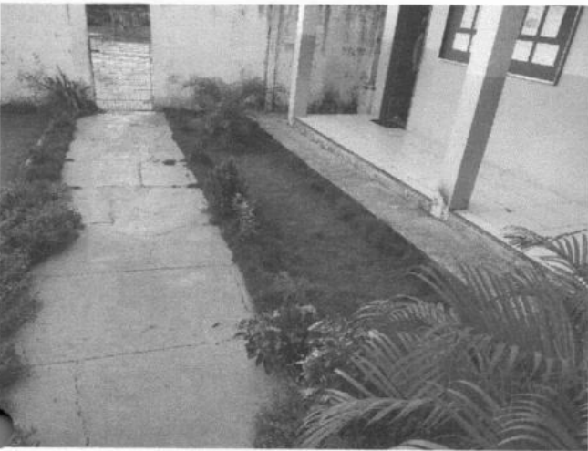
FOTO 3 - PASSARELA DE ACESSO DANIFICADA
