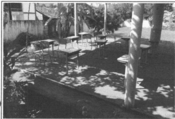
FOTO 9 - ÁREA DE CONVIVÊNCIA COM AUSÊNCIA DE PISO
