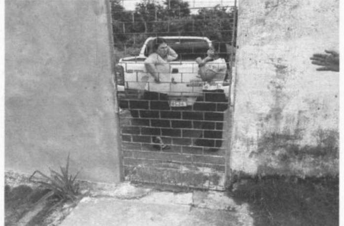
FOTO 8 - NECESSÁRIO SUBSTITUIÇÃO DO PORTÃO
