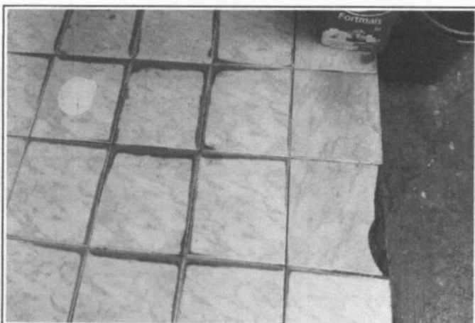
FOTO 11 - PISO CERÂMICO EM PÉSSIMO ESTADO
