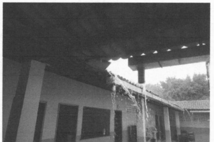
FOTO 10 - NECESSIDADE DE INSTALAÇÃO DE TUBULAÇÃO DE DESCIDA DE ÁGUA DAS CALHAS
