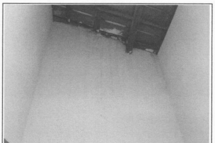
FOTO 12 - INFILTRAÇÕES EM COBERTA
