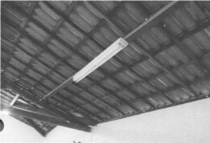
FOTO 1 - NECESSÁRIO REPARO NAS INSTALAÇÕES ELÉTRICAS
