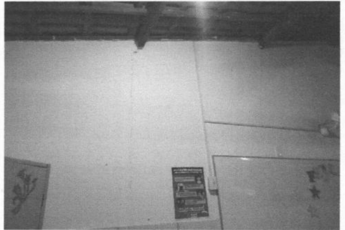
FOTO 2 - NECESSÁRIO REPAROS EM FISSURAS
