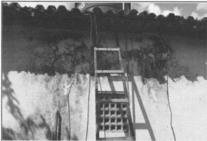
FOTO 13 - CUPINS EM COBERTA
