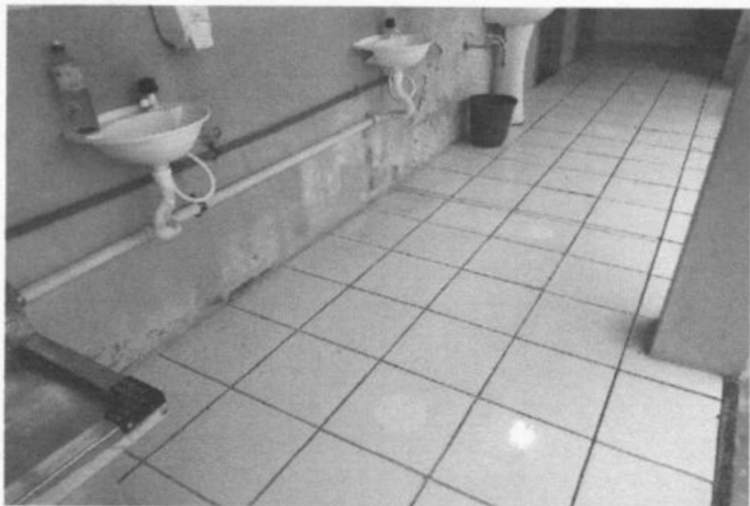
FOTO 11 - REVESTIMENTO COM ARGAMASSA DANIFICADO
