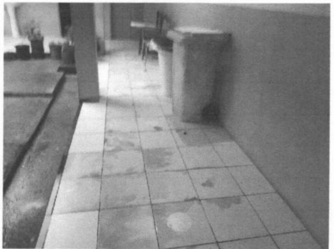
FOTO 4 - PISO CERÂMICO DANIFICADO
