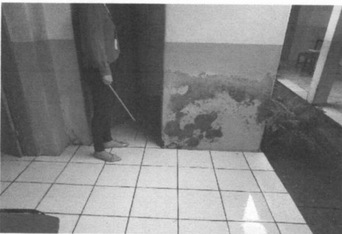
FOTO 5 - REVESTIMENTOS E PINTURA DANIFICADA
