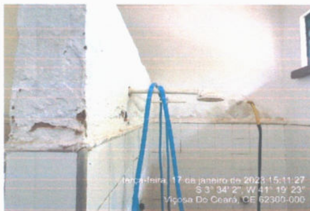
FOTO 6 - REVESTIMENTOS ARGAMASSADOS DANIFICADOS
