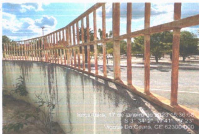
FOTO 11 - NECESSIDADE DE TROCADA GRADE DA FACHADA
