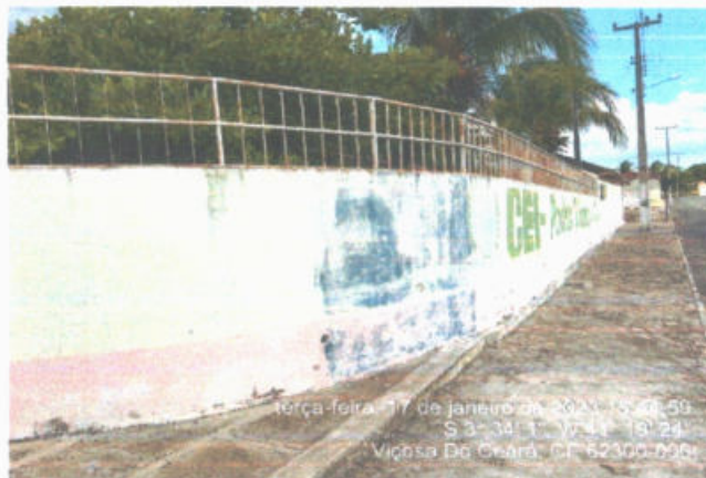
FOTO 12 - PINTURA DO MURO DANIFICADA
