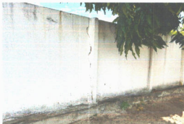
FOTO 9 - FISSURAS NO MURO DE CONTORNO
