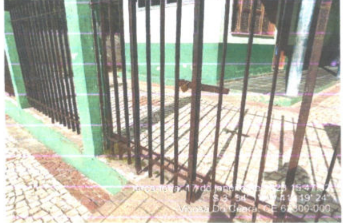
FOTO 14 - PORTÕES E GRADES DANIFICADOS
