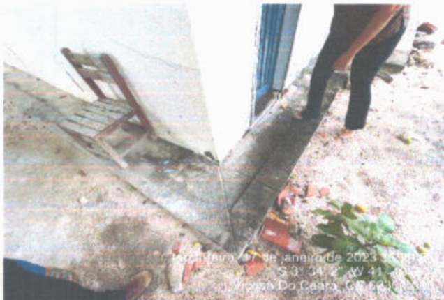
FOTO 8 - RECALQUE NO PISO DAS CALÇADAS
