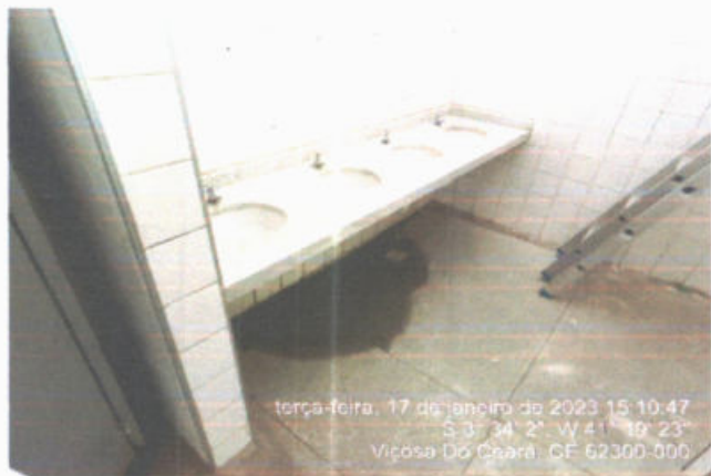
FOTO 5 - VAZAMENTOS PIAS DOS WCS INFANTIS
