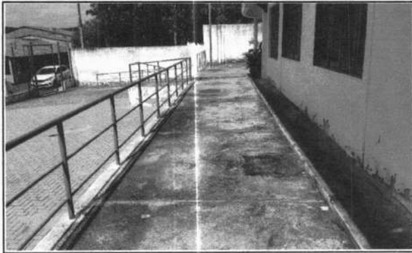
FOTO 13 - RECUPERAÇÃO DE REBOCO DETERIORADO FACHADA
