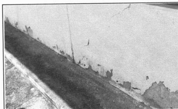
FOTO 12 - RECUPERAÇÃO DE REBOCO DETERIORADO FACHADA
