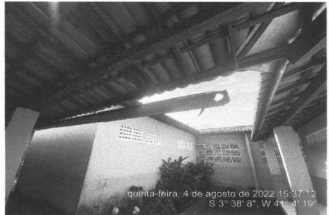
FOTO 8 - CALHAS DANIFICADAS E INSUFICIENTES
