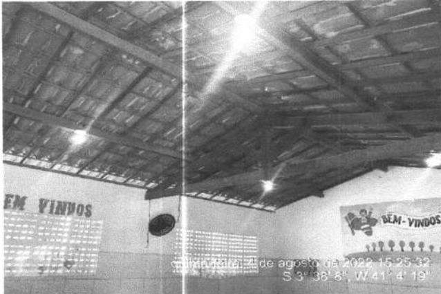
FOTO 1 - SALAS SEM FORRAMENTO
