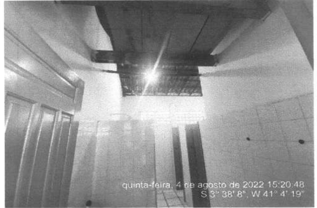
FOTO 2 - SALAS SEM FORRAMENTO
