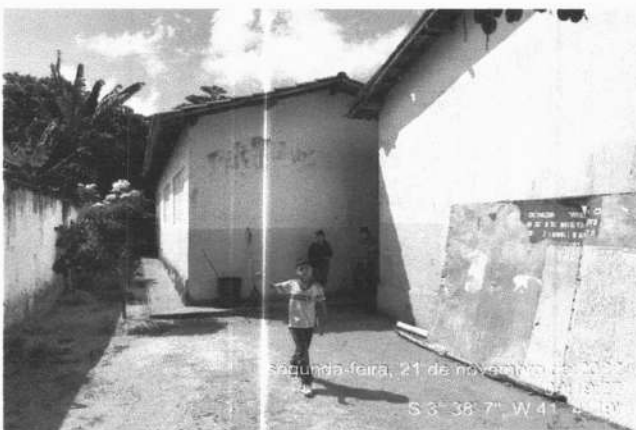
FOTO 11 - PINTURA EXTERNA DO PRÉDIO DANIFICADA
