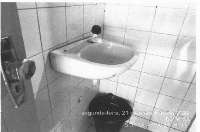
FOTO 12 - LOUÇAS DOS SANITÁRIOS DANIFICADAS
