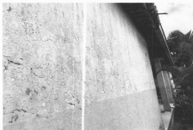
FOTO 11 - PINTURA EXTERNA DO PRÉDIO DANIFICADA
