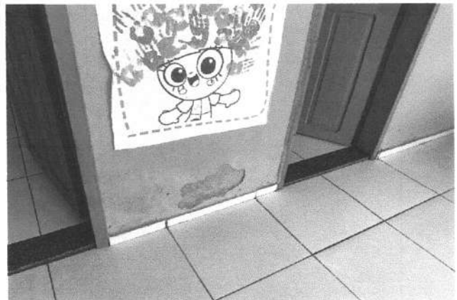
FOTO 6 - REVESTIMENTO E PINTURA DANIFICADOS
