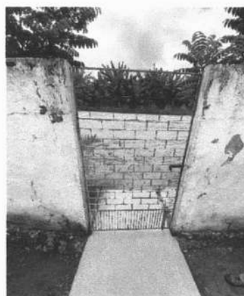
FOTO 12 - PORTÃO DO ACESSO PRINCIPAL A SER SUBSTITUÍDO
