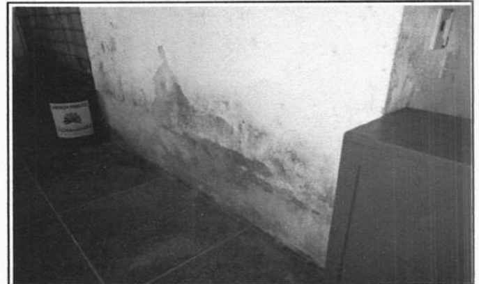
FOTO 4 - pavimento inferior (rebocos à recuperar)
