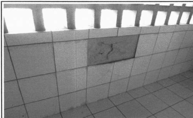
FOTO 5 - pav. Superior (descolamento cerâmica)
