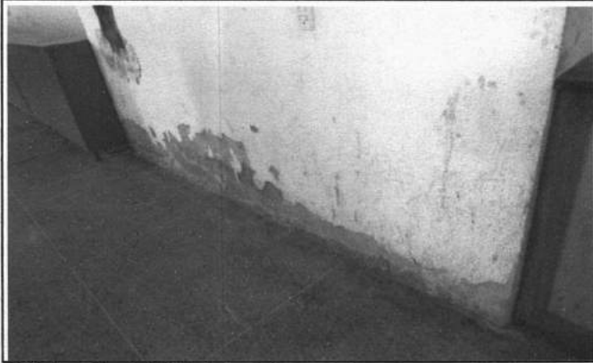
FOTO 1 - pavimento inferior (rebocos à recuperar)
