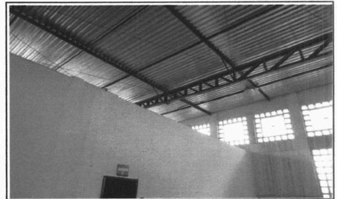
FOTO 6 - treliça à recuperar
