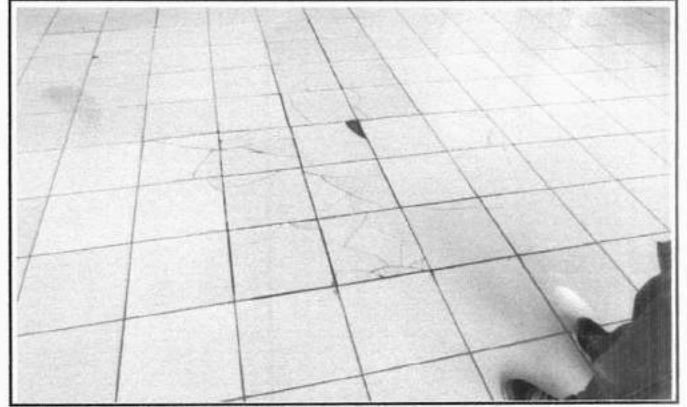
FOTO 2 - piso superior - descolamento
