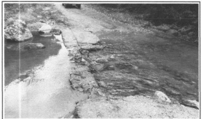
FOTO 4 - ALVENARIA DE PEDRA DANIFICADA
