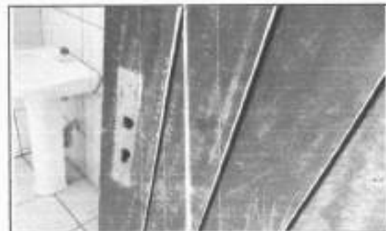
FOTO 5 - PORTA DO W.C. MASCULINO DANIFICADO
