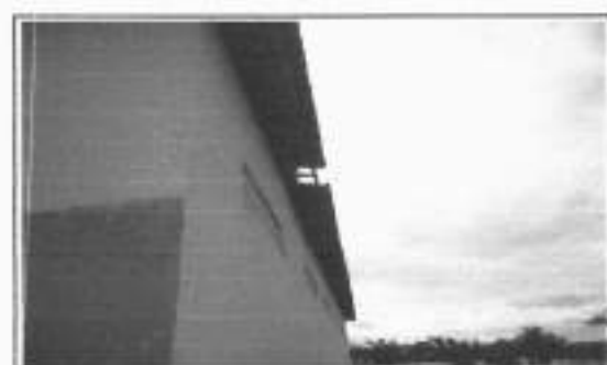
FOTO 14 - COBERTA A SER RETELHADA
