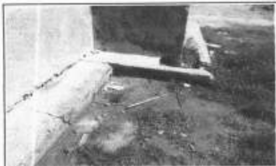
FOTO 8 - CALÇADOS DE CONTOURNO DANIFICADOS
