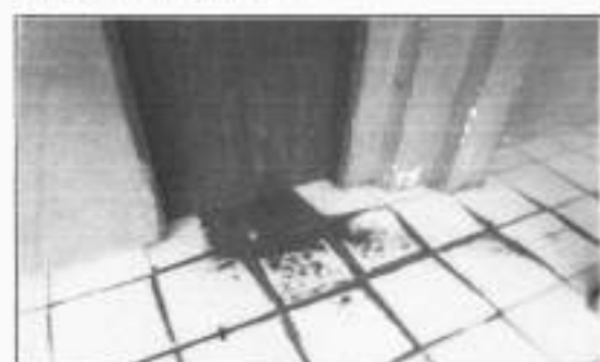
FOTO 16 - PISO CIRCULAÇÃO DANIFICADO
