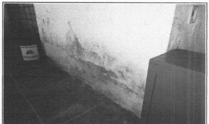
FOTO 4 - pavimento inferior (rebocos à recuperar)
