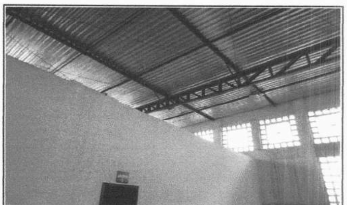
FOTO 6 - treliça à recuperar
