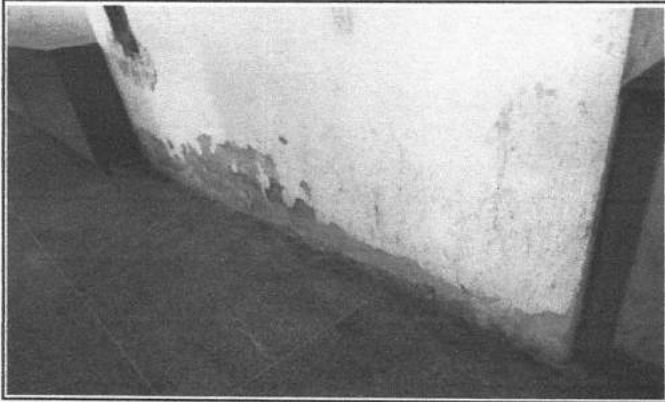
FOTO 1 - pavimento inferior (rebocos à recuperar)
