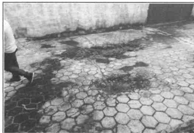
FOTO 12 - AFUNDAMENTO DE PISOS
