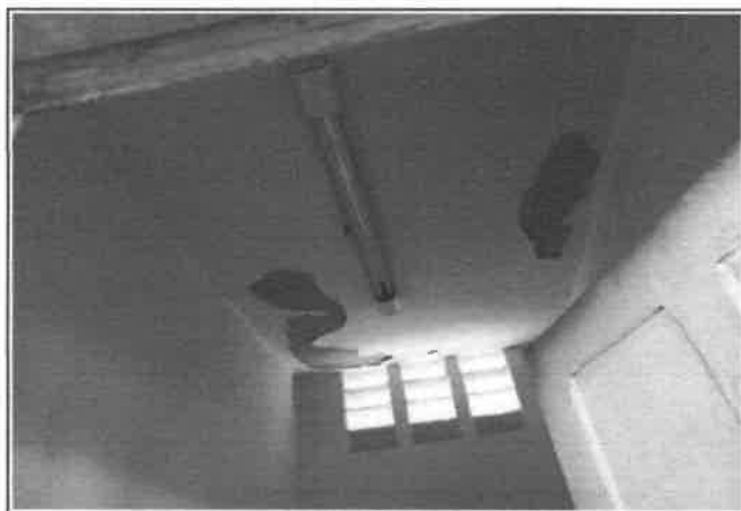
FOTO 23 - DESPLACAMENTO DE FORRO
