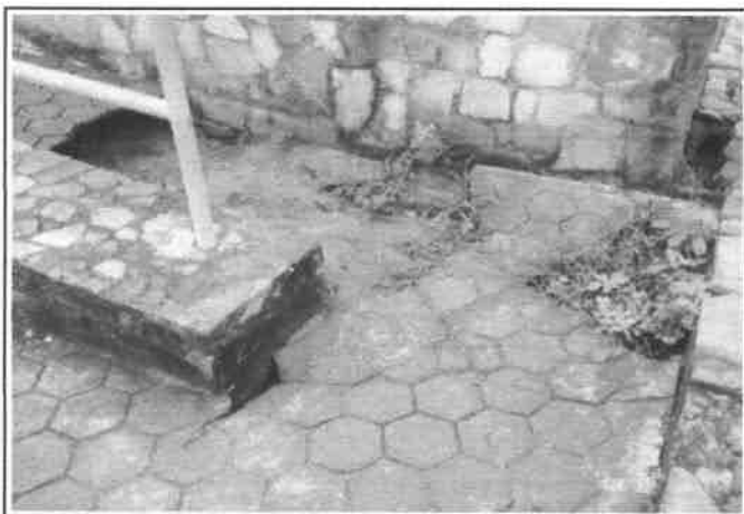
FOTO 5 - AFUNDAMENTO DE PISOS
