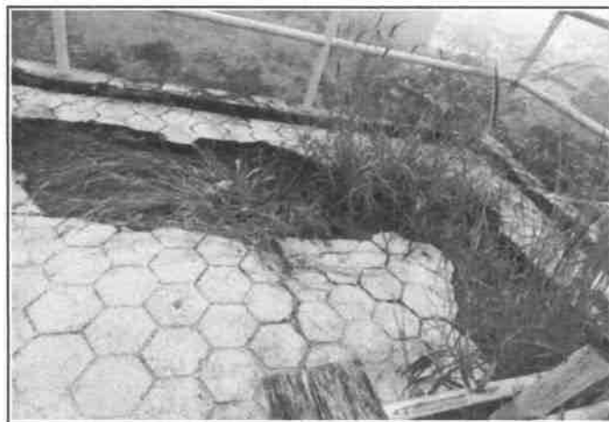
FOTO 20 - AFUNDAMENTO DE PISOS
