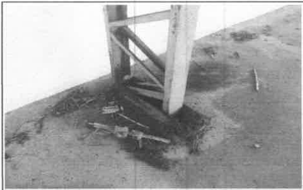
FOTO 21 - COLUNAS METÁLICAS OXIDADAS
