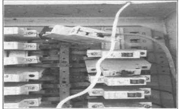
FOTO 14 - QUADRO INSTALAÇÕES LUZ E FORÇA
